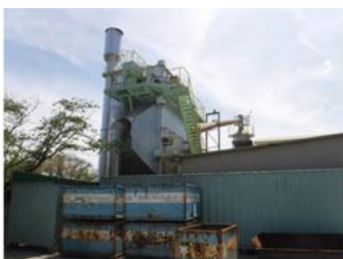
排ガス設備の電気集塵機
