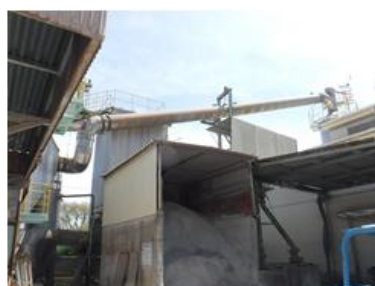
バグフィルターと急冷塔
