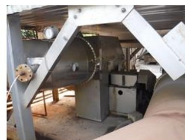
排ガス誘引ファン
